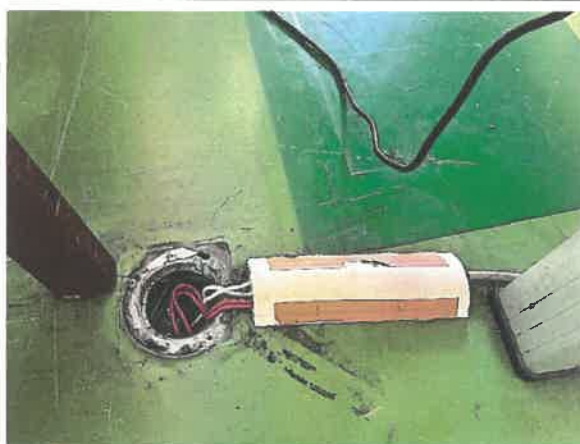
圖 1 原本的塑膠圓型孔蓋已損毀，電線直接裸露在外
